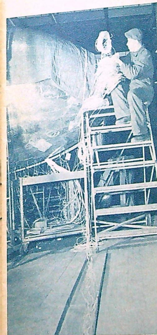
Det går åt omkring tre mil kablar enbart till instrumentutrustningen. Här håller Bror Lundvall på att reda upp dessa härvor.
