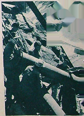
Så här klen dimension har en del av vattenrören, eftersom vattenmängderna är små. Detta kompenseras genom större fallhöjd.
