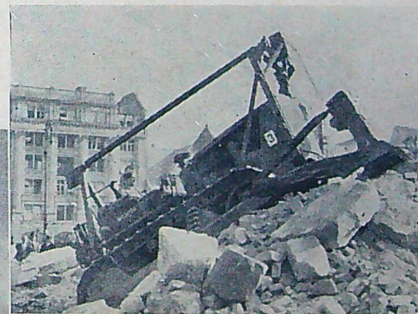
Bilderna till vänster och i mitten visar upprensingsarbeten i Hamburg. Stora traktorer och speciella lyftkranar används i största utsträckning. — t. h.: Vid vissa överfarter har färjor åter satts in.
